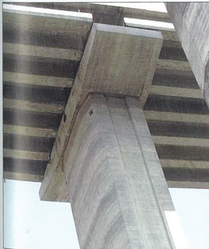
I danni provocati dal terremoto
